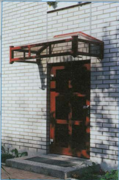
Die Eingangstür zum Wohnbereich – in der Verlängerung der Öffnungsleibungen wurden die erforderlichen Dehnungsfugen angeordnet
